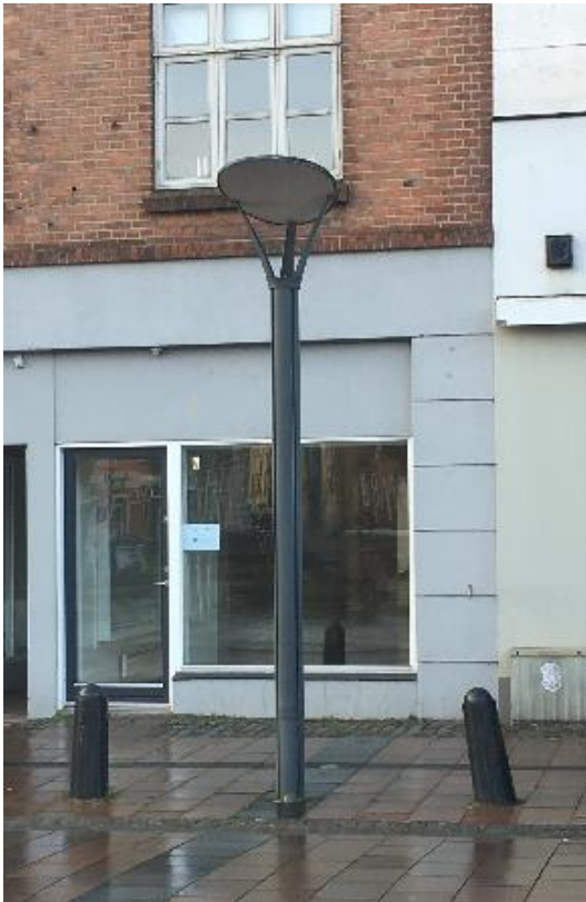
Figur 1 - Eksisterende gadelysarmatur (LightColumn)
